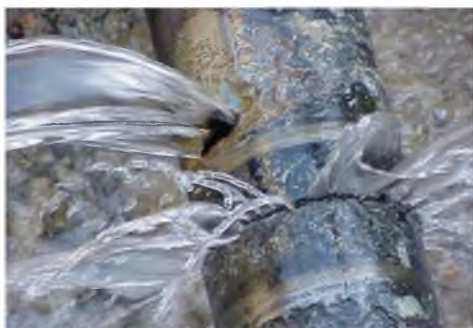
Рис. 4.30. Потери воды на магистральном водопроводе
